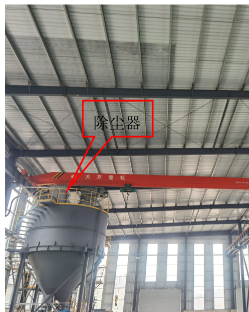
焚烧烟气处理系统灰渣仓
