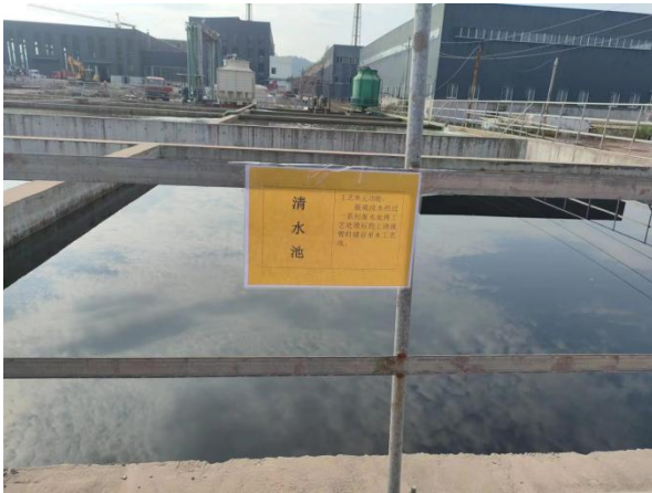
废水处理站清水池
