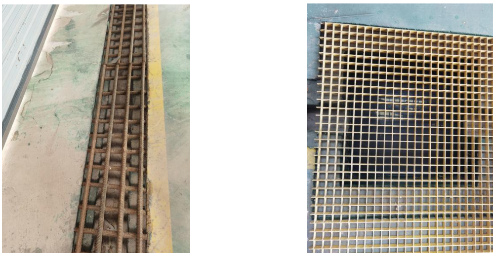
油基岩屑库房污水收集沟及沉淀池
