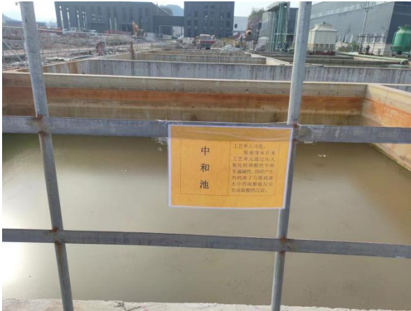
废水处理站中和池
