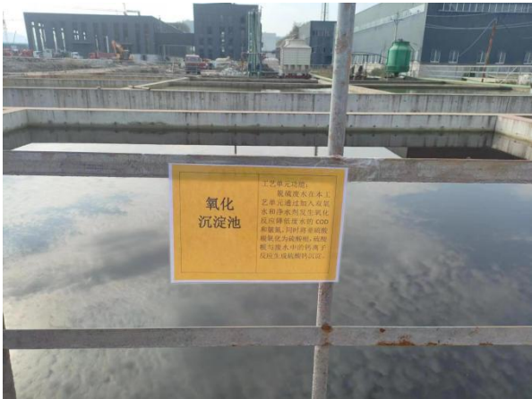
废水处理站氧化沉淀池
