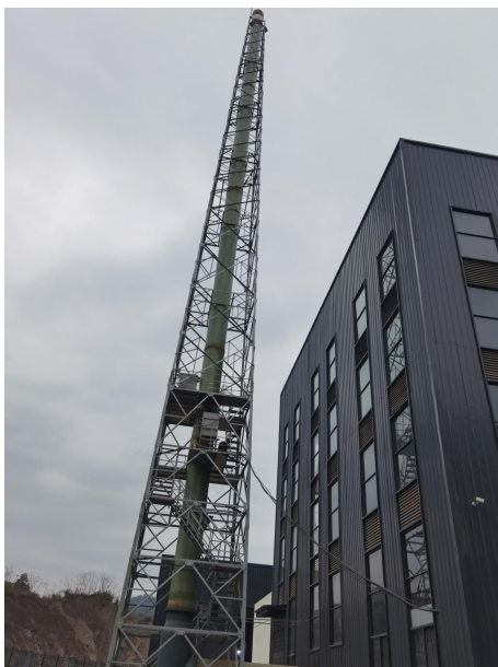
50m 高排气筒
