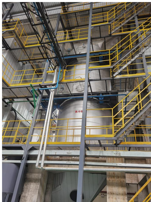
烟气净化工艺中急冷塔
