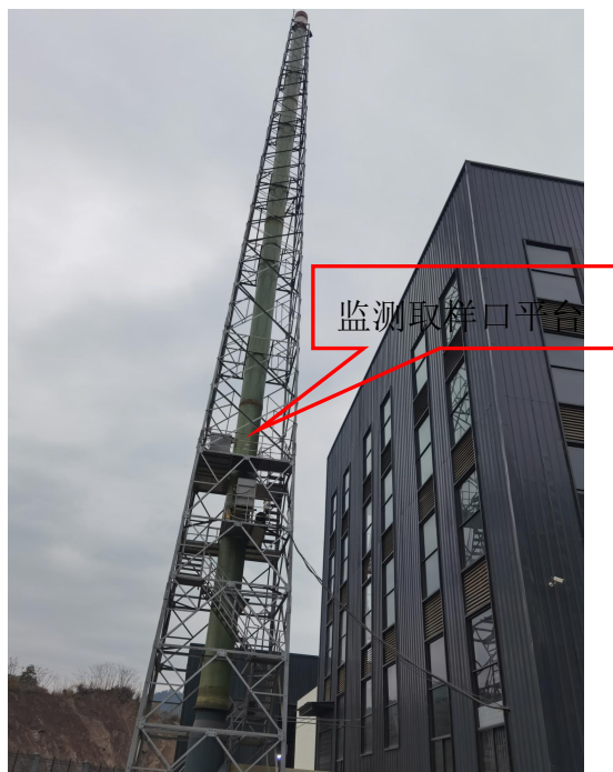
排气筒监测取样口
