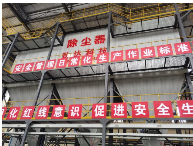
烟气净化工艺中布袋除尘器
