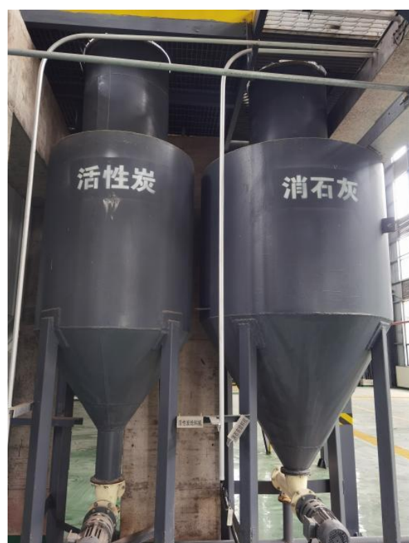
烟气净化工艺中活性炭及石灰喷射装置
